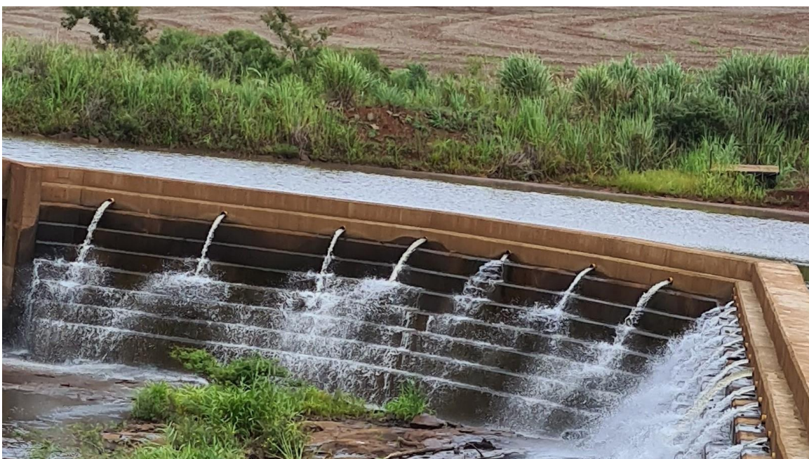
Figura 01: O barramento da CGH OURO BRANCO e seus dutos que garantem a vazão sanitária.
