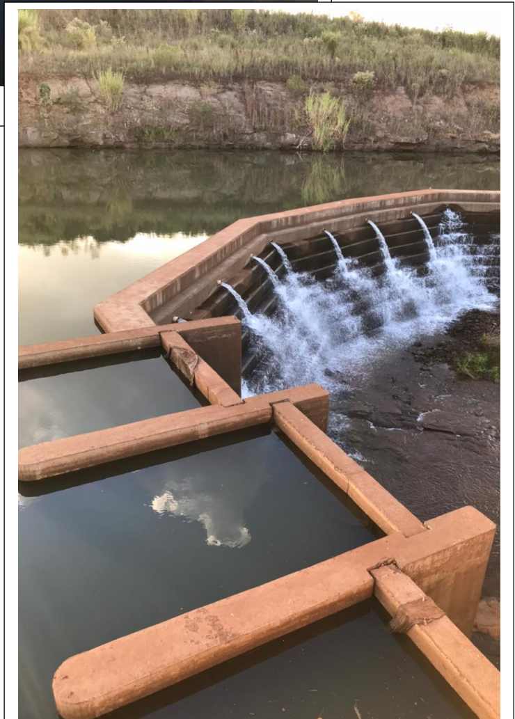
02: Sistema de vazão sanitária e estrutura do barramento
